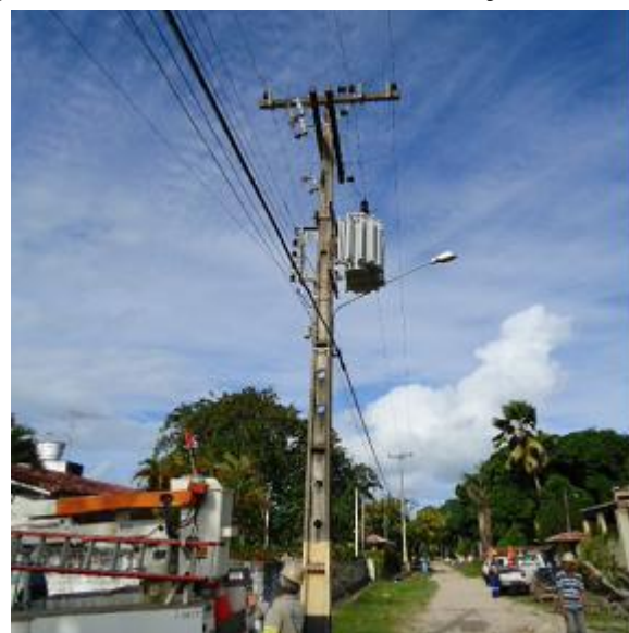
Figura 4 - Transformador de distribuição
