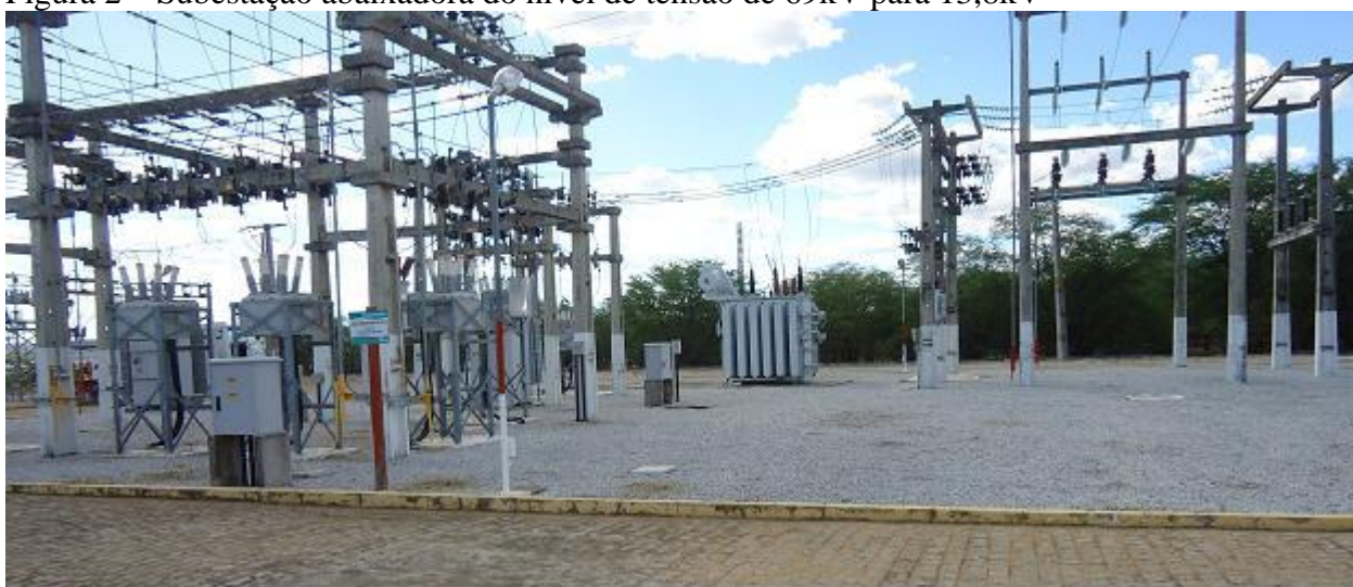
Figura 2 – Subestação abaixadora do nível de tensão de 69kV para 13,8kV
